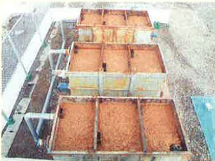
灯油流出事故現場油水分離槽
