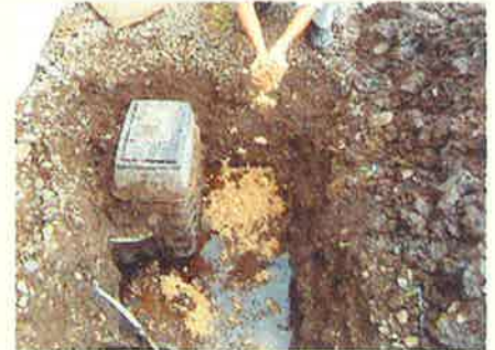
タンクからの灯油流出
